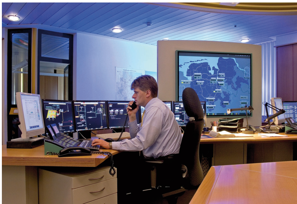
Kompliziert und komplex: Blick in eine Schaltzentrale
