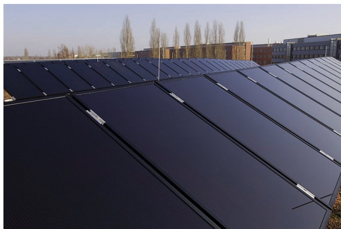
Modernste Chalcopyrit-Dünnschicht-Technologie im Einsatz: 1 kW Testanlage in Berlin-Adlershof
